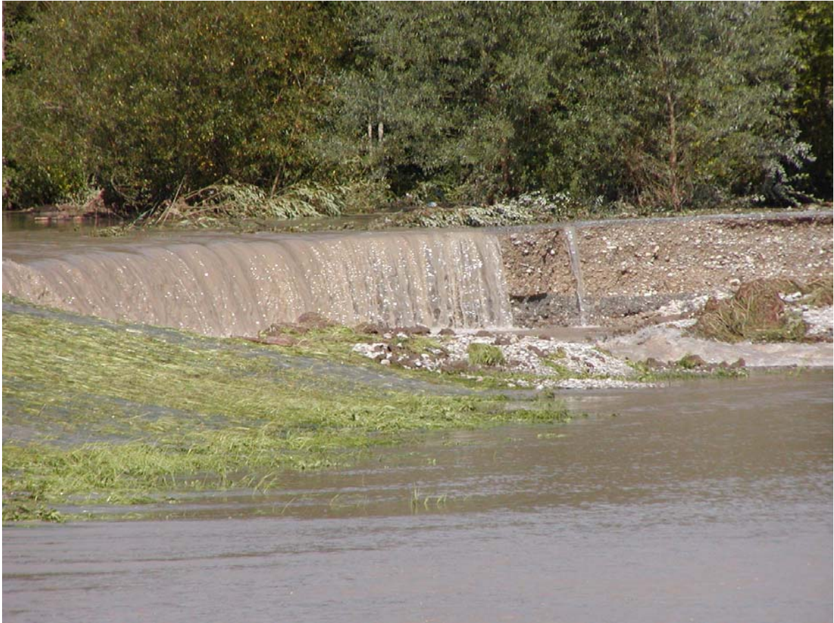
Abb. 20: Erheblich überlasteter Deich, der dank befestigtem Deichkronenweg und gebundener Innendichtung trotz dramatischer Beschädigung standfest blieb.
